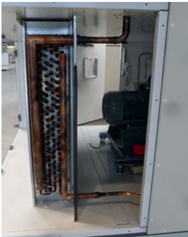
Kondensator im RLT-Gerät
