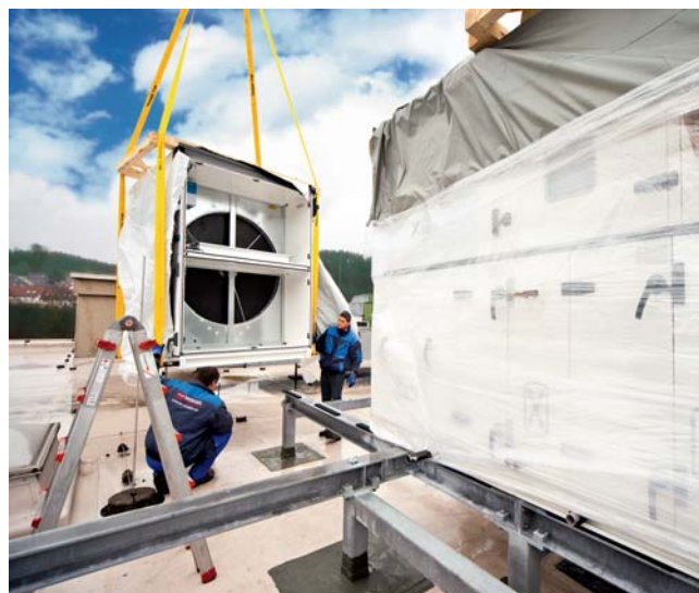
Auslieferung und Montage eines wetterfesten RLT-Gerätes X-CUBE
