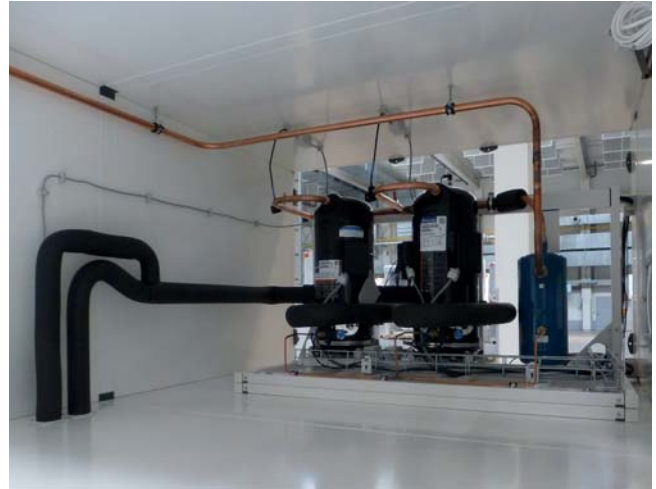
Verdichter im RLT-Gerät
