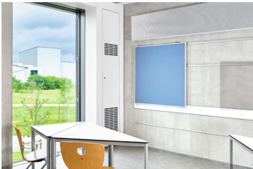
SCHOOLAIR-V-HV im Gymnasium, Wendelstein
