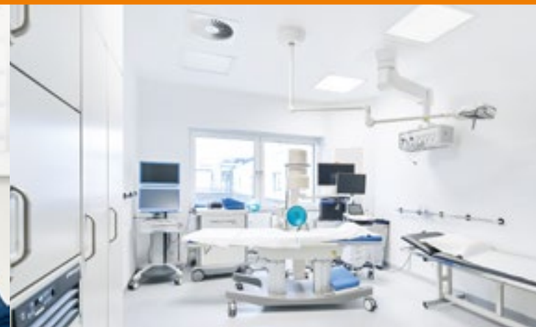
Die bedarfsgerechte Regelung ist ökonomisch und energieeffizient – und garantiert optimales Wohlfühlklima für Patienten und Personal.
