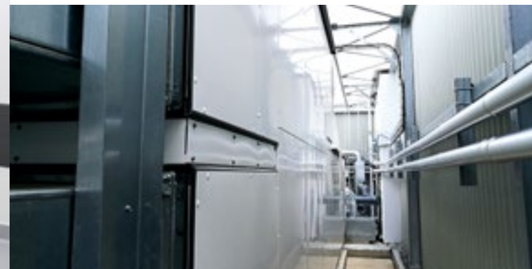
TROX X-CUBE-Lüftungsgeräte generieren 153.000 m 3 /h aufbereitete Luft.
