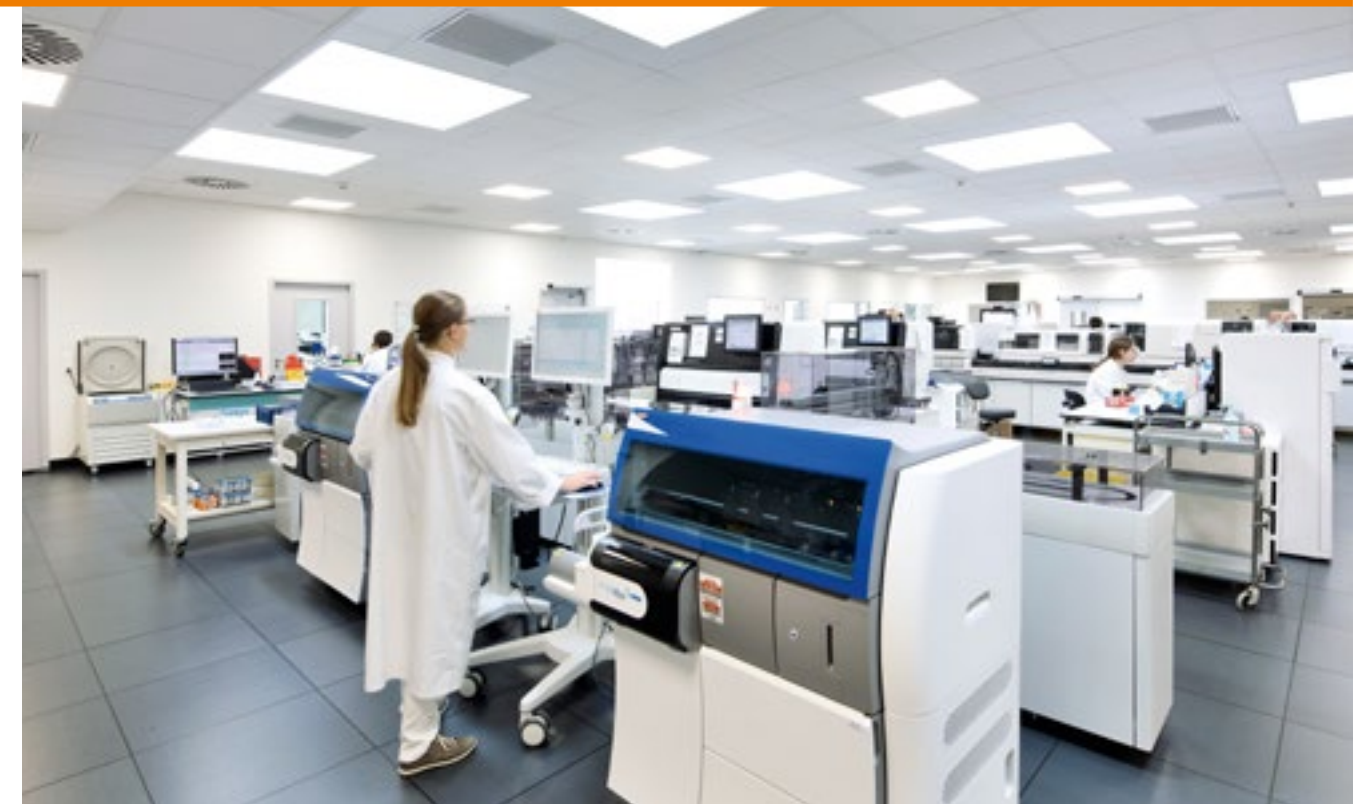
Für einen optimalen und sicheren Betrieb des Labors hat man hier auf die Systemtechnik von TROX gesetzt.
