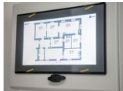
Im Laborgebäude ist eine festgelegte und zu überwachende Überdruckhierarchie zwingend erforderlich.
